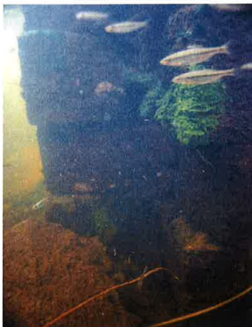
Pile 1 : A l'avant bec, des assises se sont effondrées du fond à la ligne d'eau, hauteur 1,50m.
